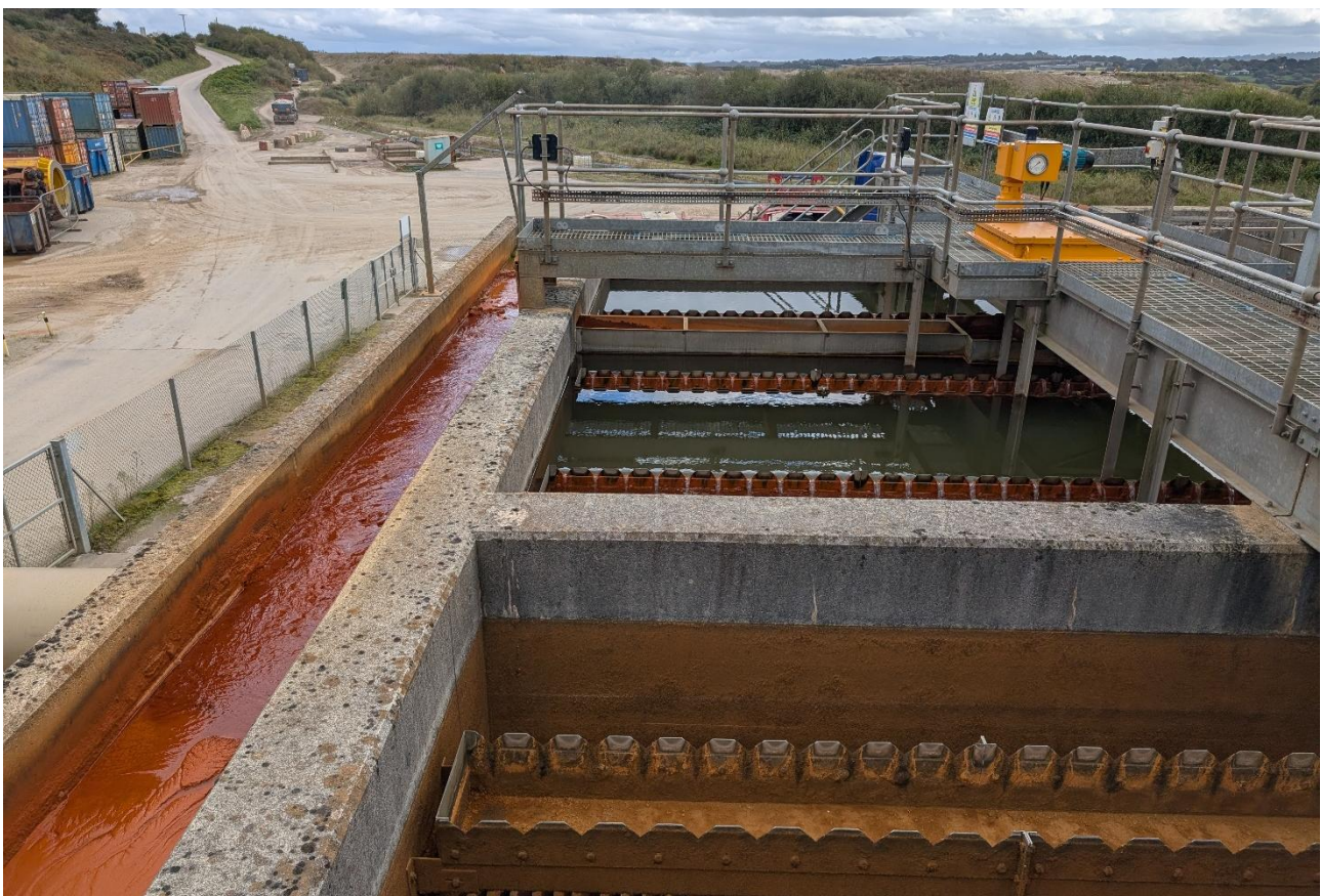
Entleerter Lamellenklärer der Aufbereitungsanlage
