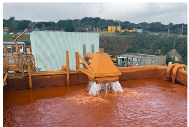
Wassereinleitung in das Vormisch- bzw. Oxidationsbecken der Aufbereitungsanlage
